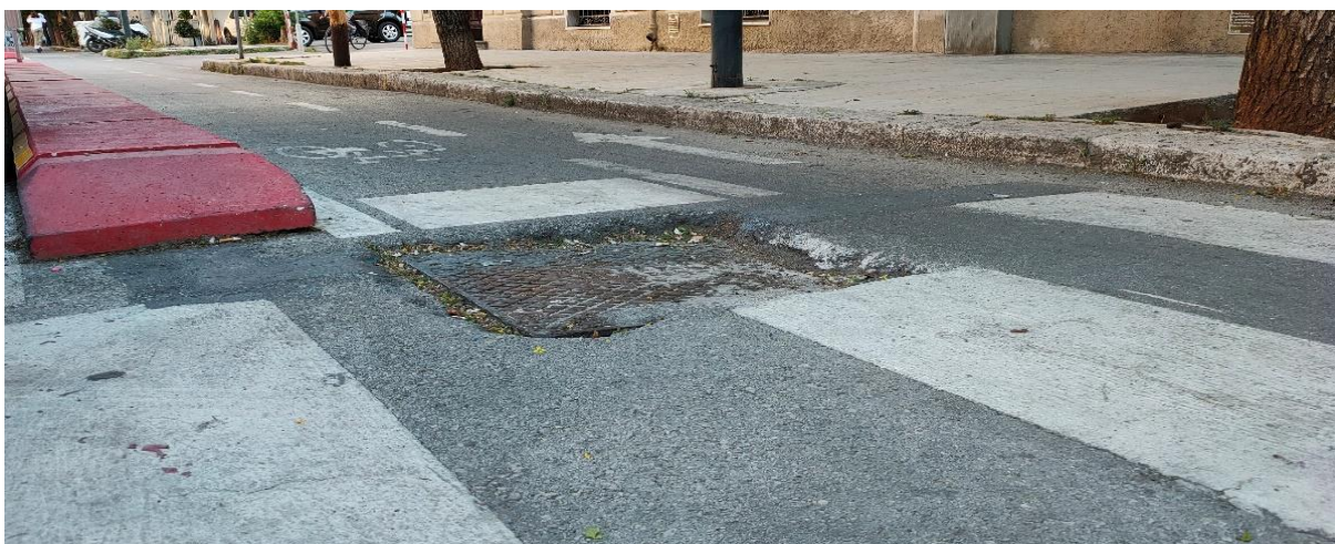
Foto 18: sottoservizio/buca pericolosa in via G. Leopardi
